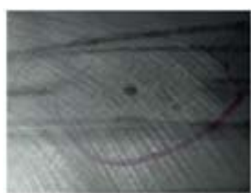
板金表面凹凸跡
